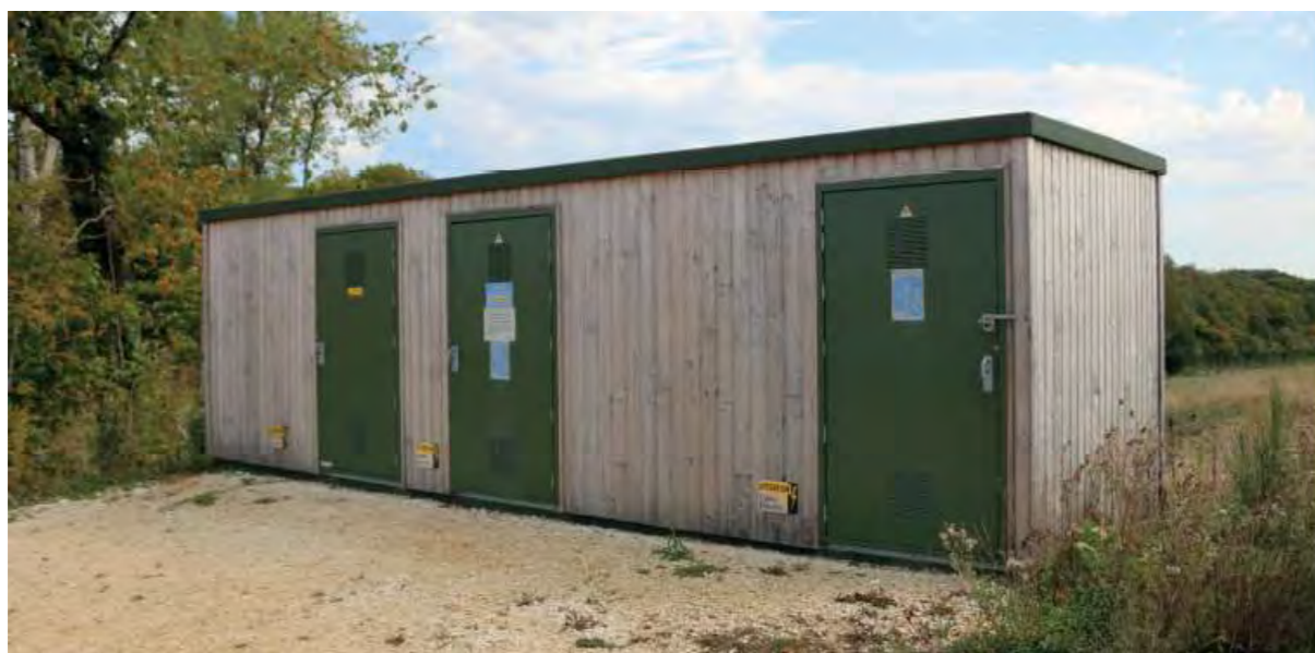
Figure 112 : Exemple de poste de livraison avec bardage bois vertical
